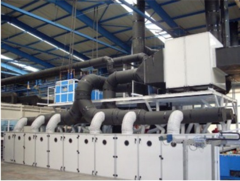
Trakya Cam San.A.Ş. Otocam Fabrikası CH 4 baskı odası klima sistemi
