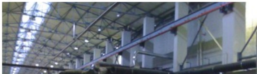
„Тракия Джам Санайи” А. Ш.- Завод за автомобилно стъкло - България Изработка и монтаж на контролни зали, климатични системи с модул за овлажняване
